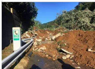
②中央道④ 43.6KP 土砂流入
