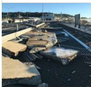
⑤西湘バイパス 被災状況
