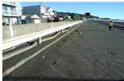
⑤西湘バイパス 土砂堆積
